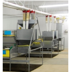
Рис. 101. Передаточні бункери на кліткових батареях
