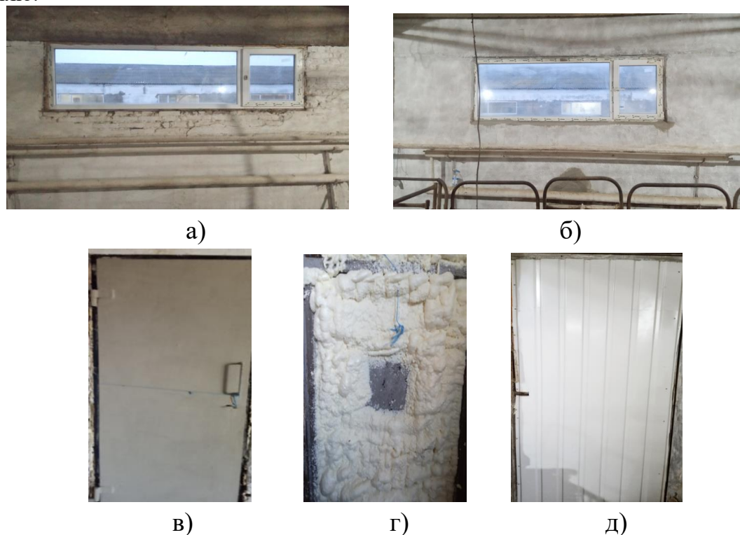
Рис. 2 Зовнішній вигляд деяких огорожувальних конструкцій приміщення: а) – фрагмент внутрішньої поверхні стіни з деякими пошкодженнями; б) – фрагмент внутрішньої стіни після проведення ремонтних робіт; в) – металеві двері покриті 1,5 мм шаром Керамоізолу; г) – металеві двері покриті напиленим Пінополіуретаном товщиною 30 мм; д) – металеві двері покриті напиленим Пінополіуретаном та захищені листовим метало-профілем.
